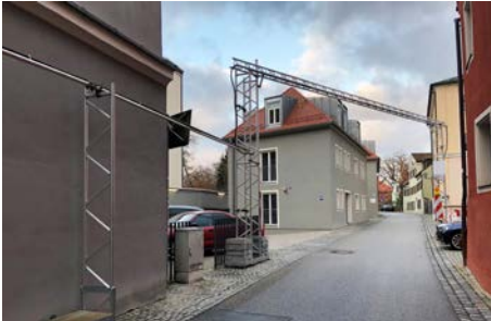
Abb. 1 Hochgelegte Leitung zur Straßenquerung (Kabelbrücke)
