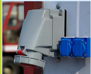
Steckdosen (unbekannte Schutzmaßnahme)
