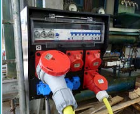
Stromverteiler mit Steckdosen (stationär)
