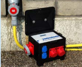
Stromverteiler mit Steckdosen (mobil)
