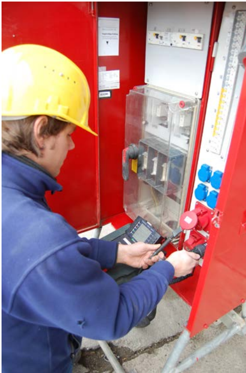
Abb. 19 Inbetriebnahmeprüfung eines Baustromverteilers nach VDE 0100-600
