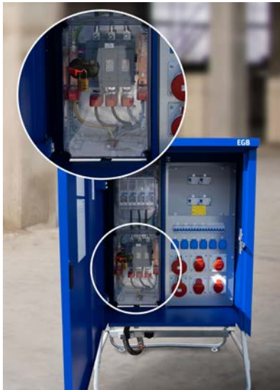
Abb. 9 Baustromverteiler mit Festanschluss
