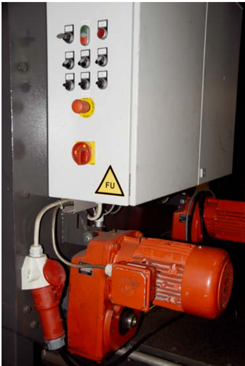
Abb. 13 Beispiel für die Kennzeichnung eines Betriebsmittels mit Frequenzumrichter (FU)
