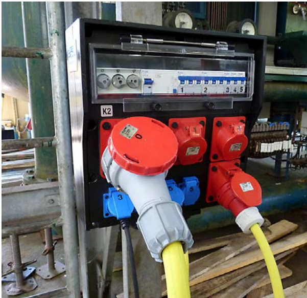
Abb. 18 Stationärer Verteiler mit zugewiesenen, geprüften Steckdosen und geeigneter RCD
