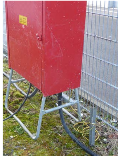
Abb. 4 Beispiel für eine fachgerechte und zuverlässige Ausführung der Erdung
